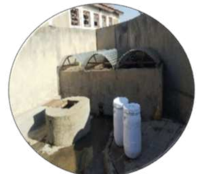
Bac de séchage : là où les boues sont traitées avec de l'eau (utile pour le traitement de boue)
